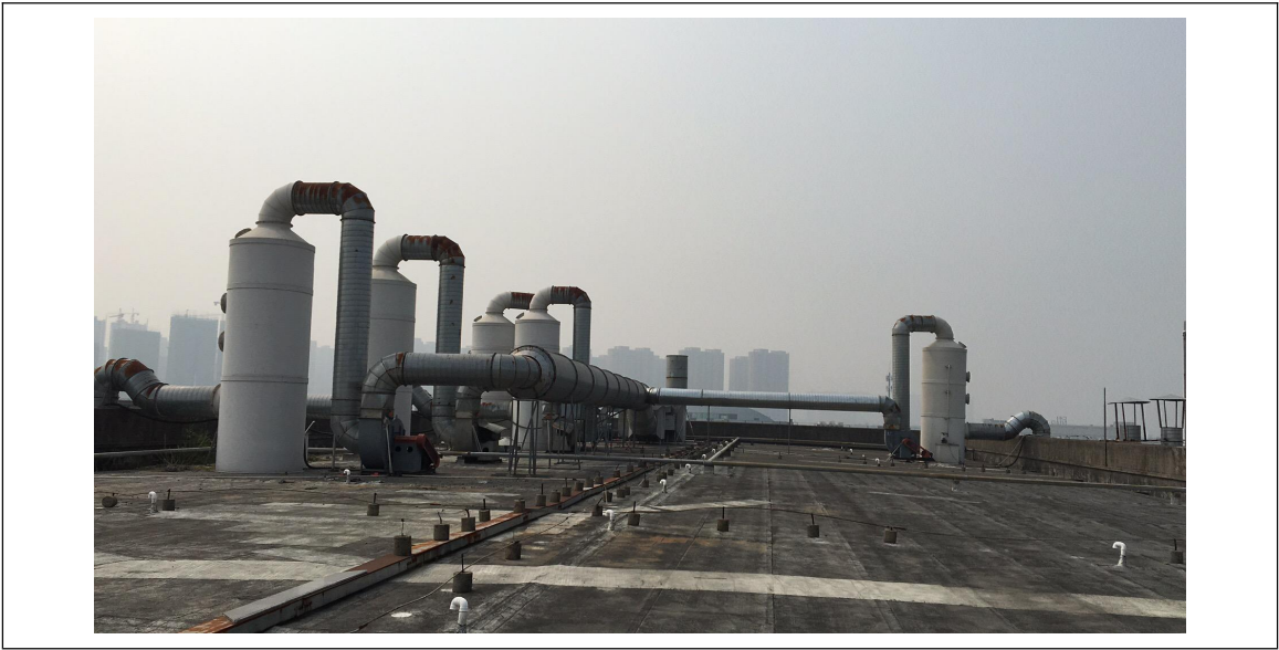
图 4.1-3 有机废气处理相关照片
